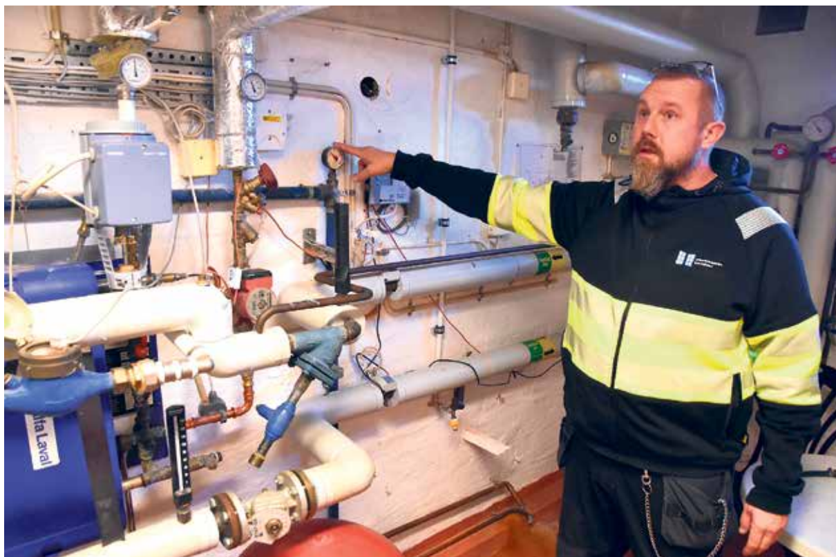
Rickard Andersson undersöker så att undercentralen i kvarteret Herden funkar som den ska. I dag finns det inget att åtgärda, vilket är skönt.
